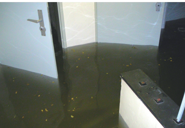
Wasser im Keller des ehemaligen MGH nach Starkregen
